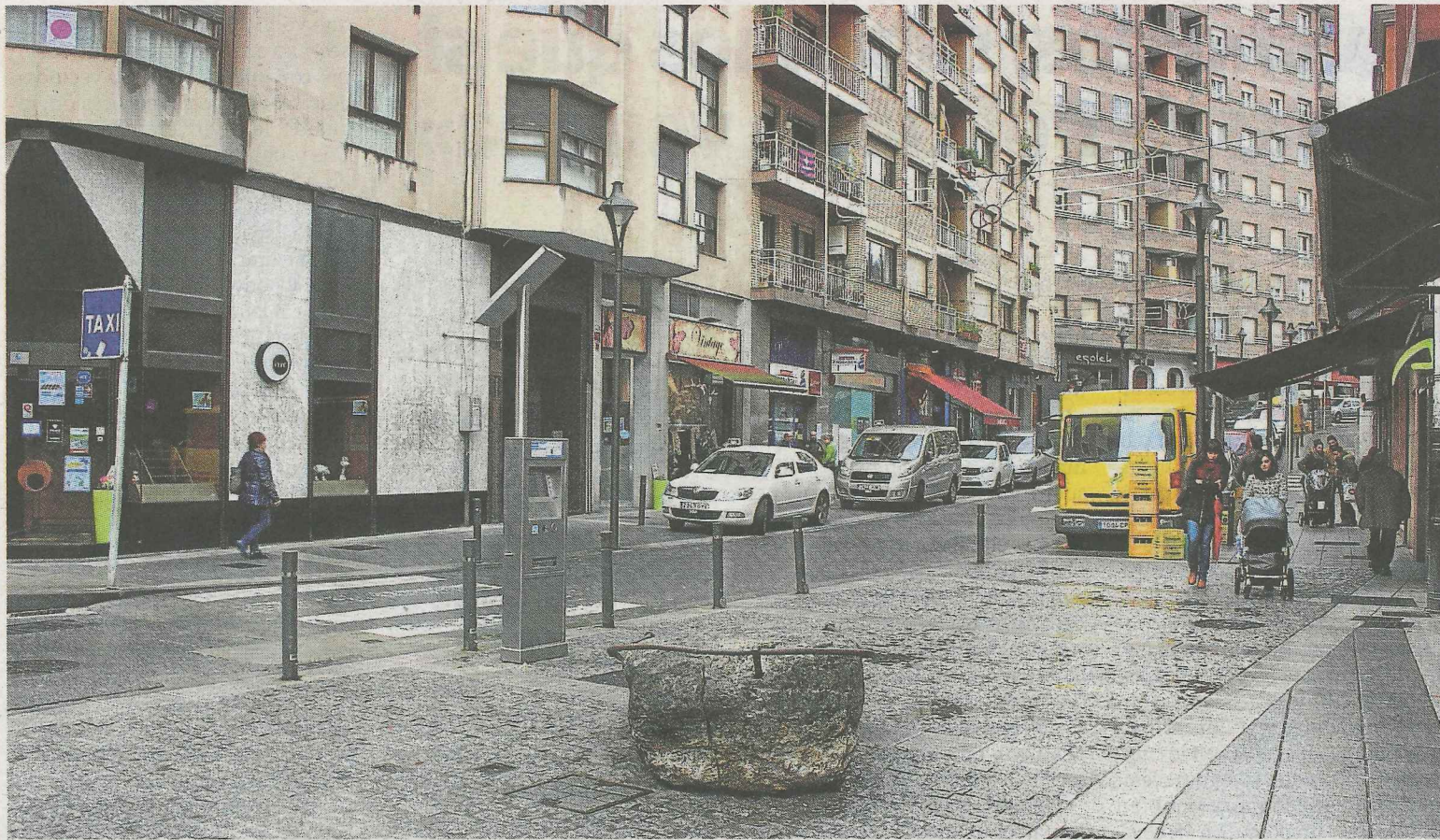
La calle Probaleku pasará a ser semipeatonal y para ello se prevé la realización de varios trabajos sobre el asfalto. :: A. LASUEN
