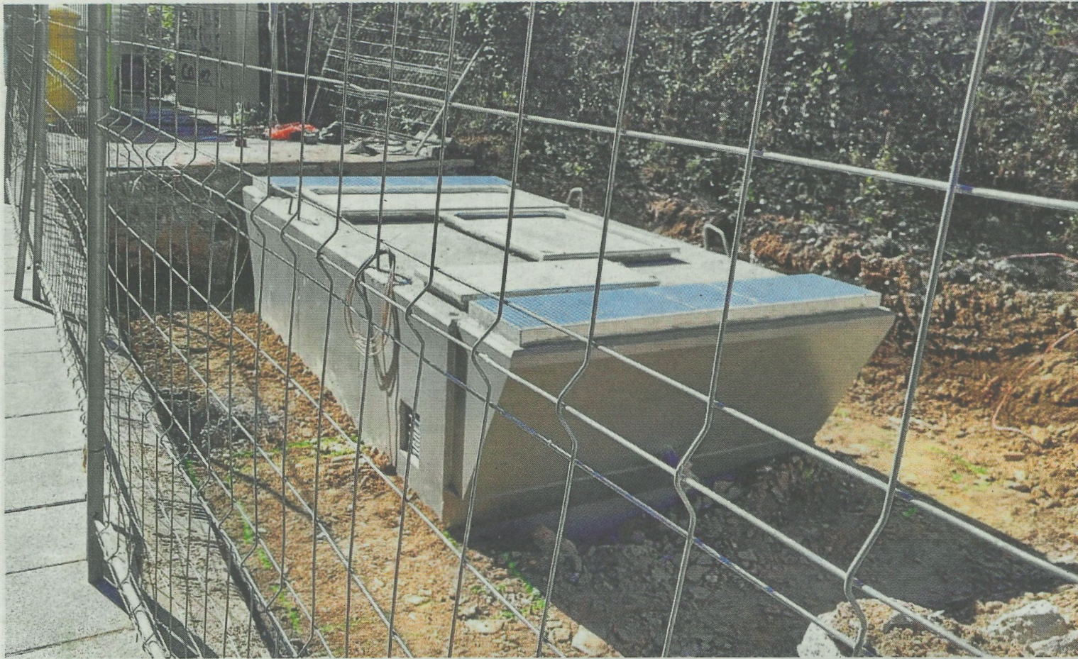
En toda la zona que circunda Zearkale se han instalado y conectado diferentes transformadores como el que aparece en la imagen. A.LASUEN
