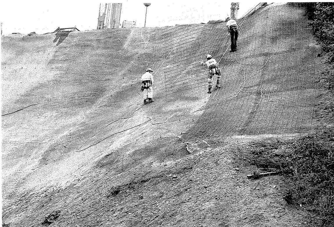
Trabajos realizados recientemente para estabilizar la ladera de la zona de Aldapa. :: A. L.
