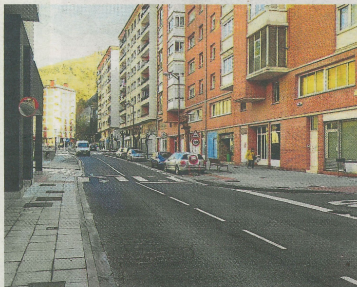
Las obras afectan a la red subterránea de abastecimiento de agua. E.C.
