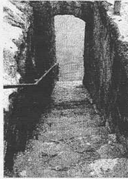
ARREGLO. Las escaleras de acceso a la piscina necesitan un arreglo. /GORRITIBEREA
