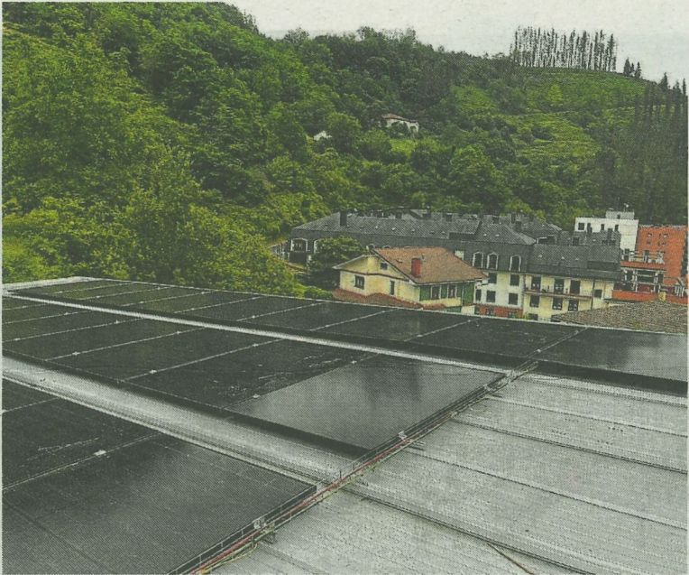
Las placas solares para el barrio de Santa Ana ya están instaladas. AYTO.
