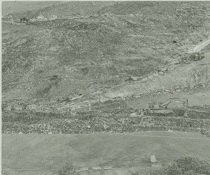
Lakua asumió de urgencia estabilizar la zona de Zaldibar. Foto: B. G.
