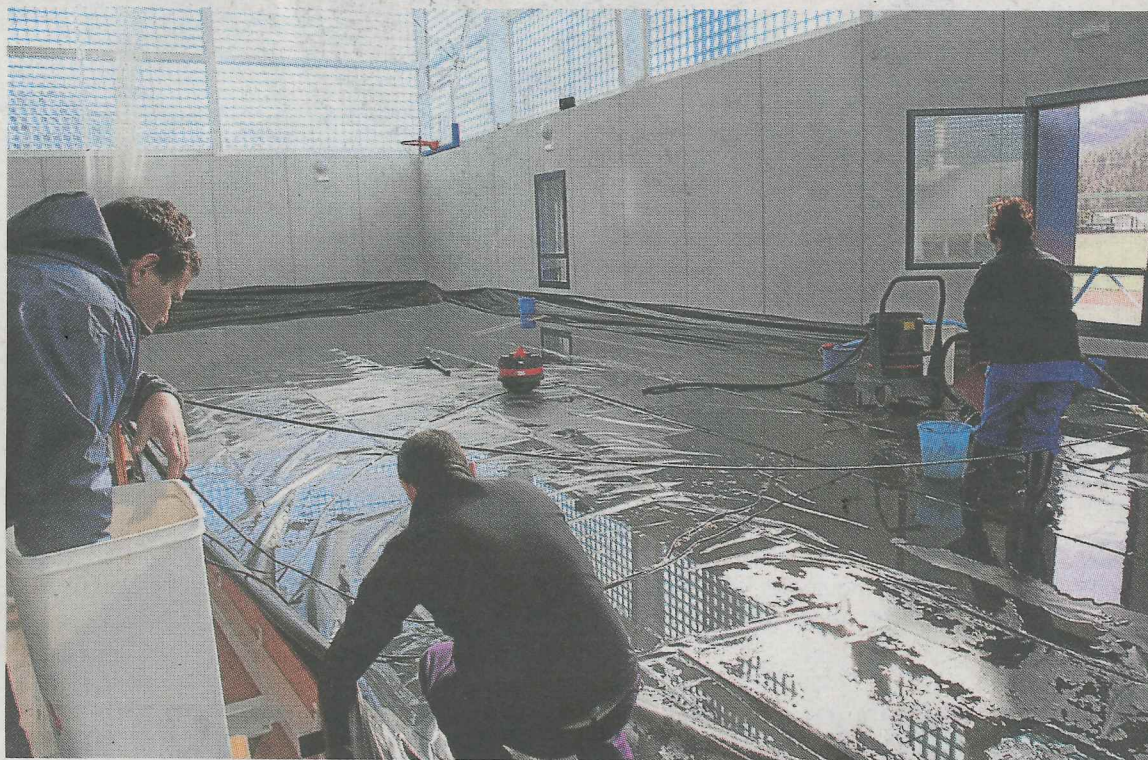
Trabajos que se llevaron a cabo en la cancha tras resultar dañada la cubierta. :: A. LASUEN
