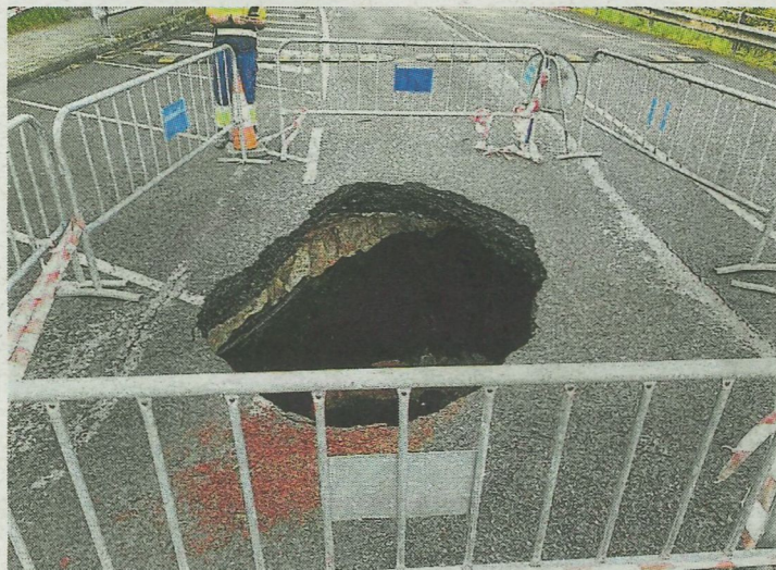
El acceso está totalmente prohibido. Foto: Zornotzako Udala
