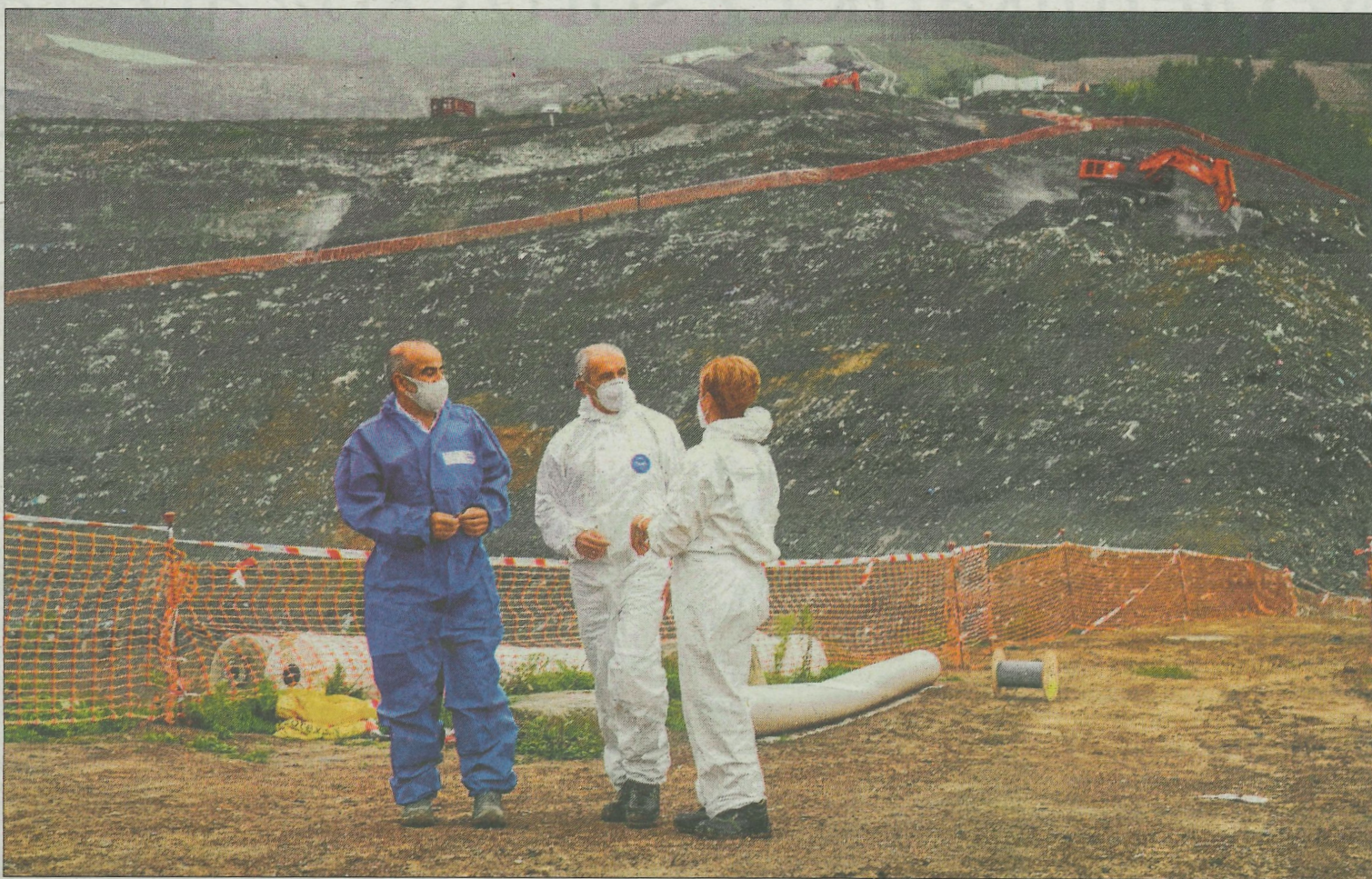
Josu Erkoreka y Arantxa Tapia, en las obras del vertedero derrumbado en 2020.
