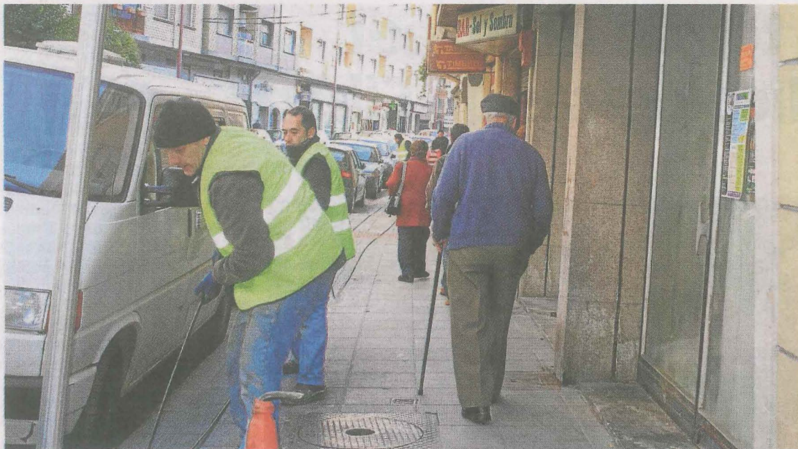
Labores de instalación de la fibra óptica que se llevaron a cabo en las calles de Ermua. :: A. LASUEN
