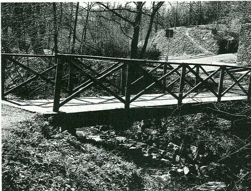
RENOVACIÓN. Los puentes del camino verán desaparecer sus viejas barandillas de madera. / A. L.
