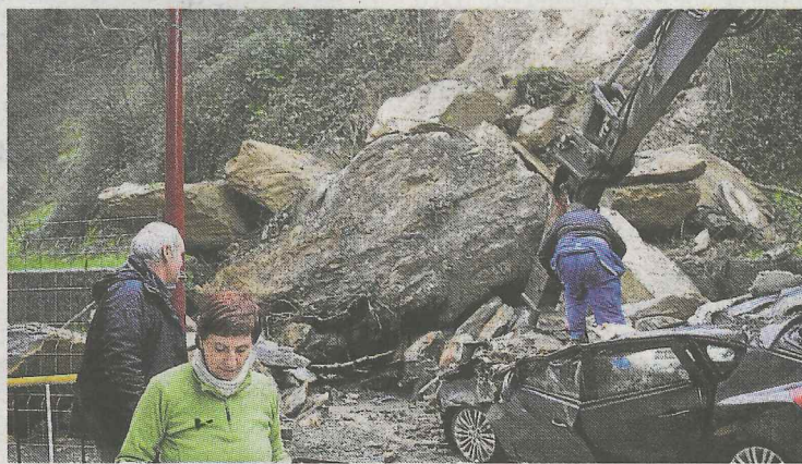
Un coche fue sepultado en el desprendimiento de marzo. :: I. PÉREZ
