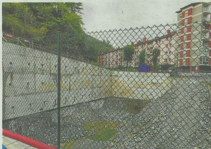
El solar se encuentra abandonado y las obras paralizadas. A. L.
