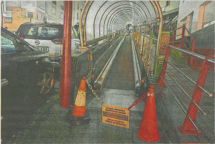
La rampa afectada lleva más de cuatro meses fuera de servicio. A. L.
