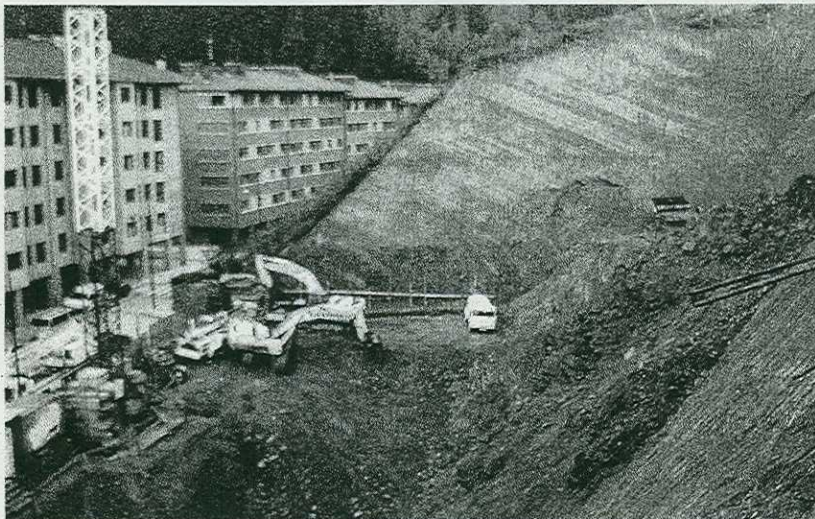
FRACTURA. El terreno se ha revelado como más blando de lo previsto /A. L.
