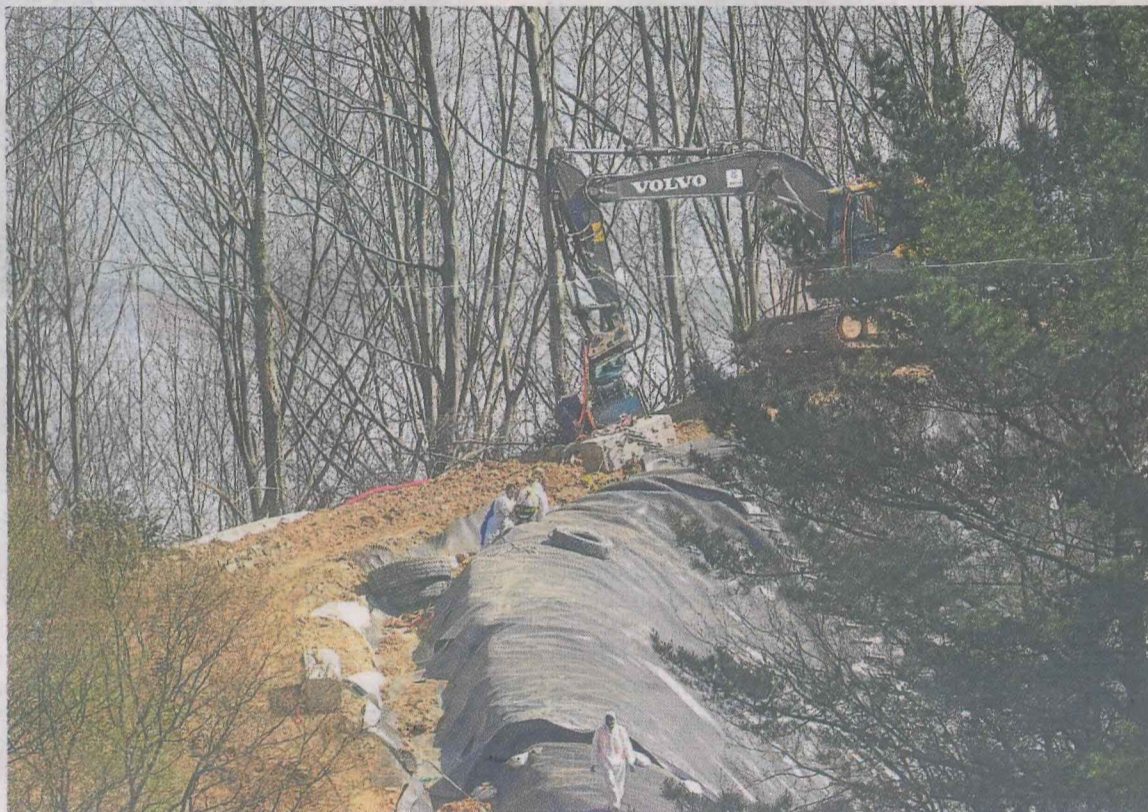
Una brigada de operarios trabajaba el viernes en la construcción de un depósito junto al vertedero. I. PÉREZ
