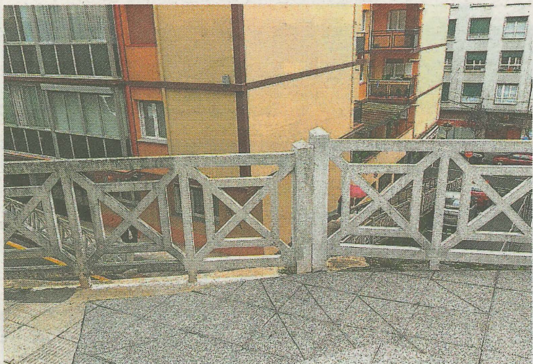
Esta barandilla muestra el antes y después de la limpieza. AYTO.
