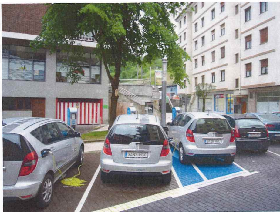
Ilustración 12: Cargadores de vehículos eléctricos colocados en el vecino municipio de Elgoibar
